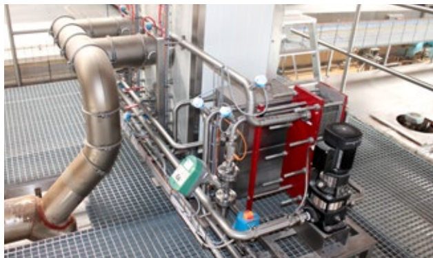
Das innovative Modulsystem wird unterschiedlichen Leistungsklassen und Prozessparametern gerecht.
