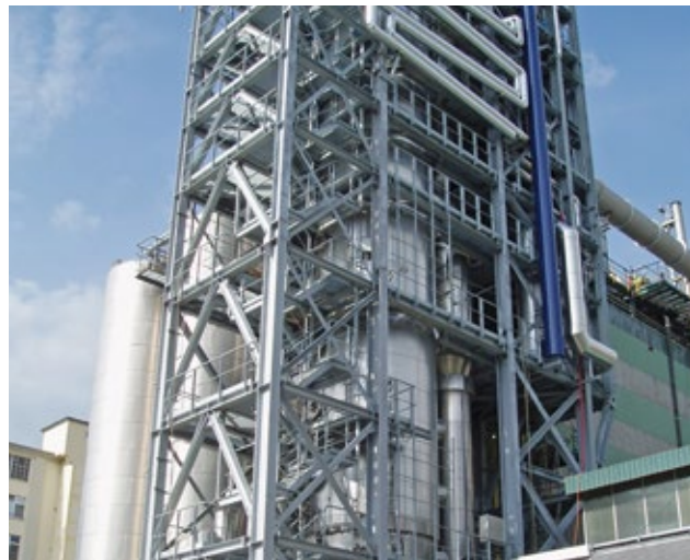
An der Desodorierungsanlage wurden im Rahmen der Technischen Risikoanalyse technische und organisatorische Schwachpunkte identifiziert und Maßnahmen zur Minimierung des Ausfallrisikos entwickelt.
